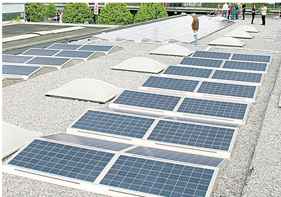
Die neue Photovoltaik-Anlage auf dem Dach der Roland Meier AG.
